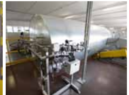
Anlæg til efterbehandling af emission fra ovnen
